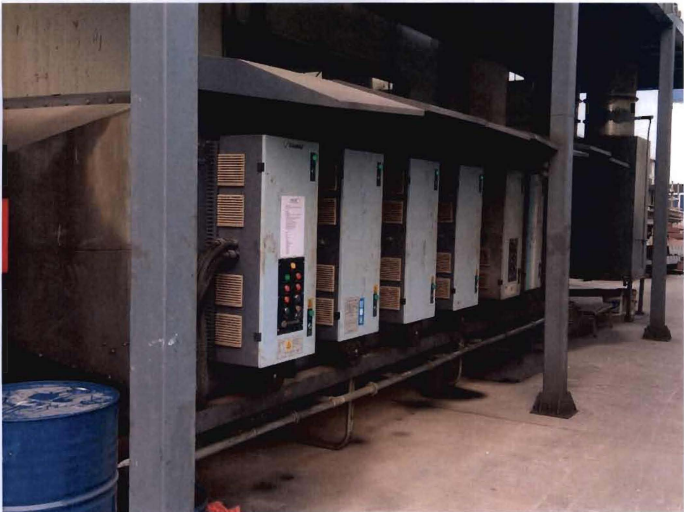
附件 5 静电净化回收装置照
