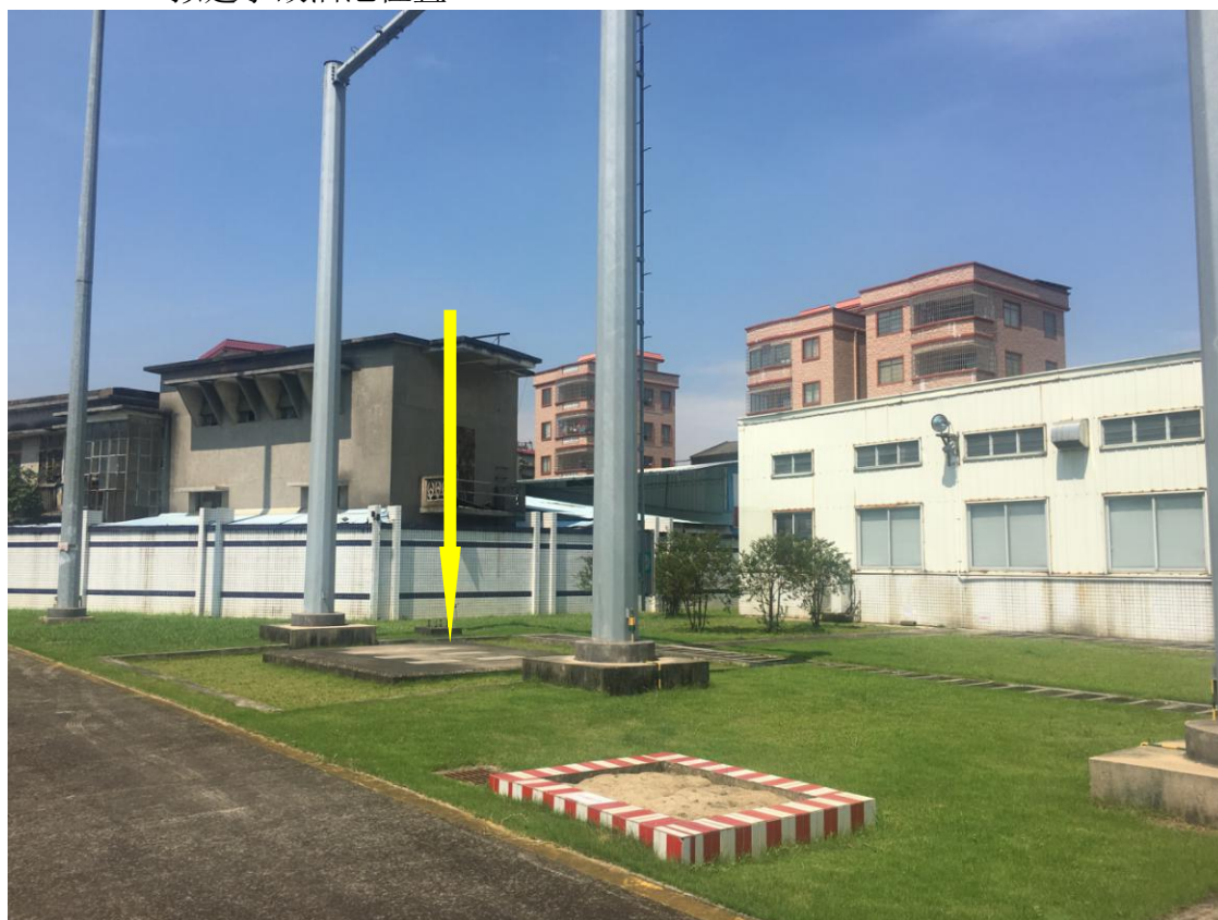
#2 主变扩建位置
