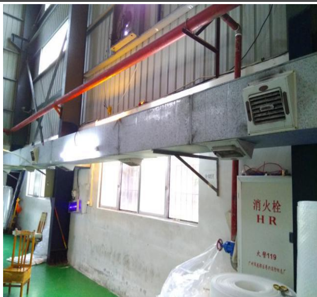
吹膜车间送风系统
