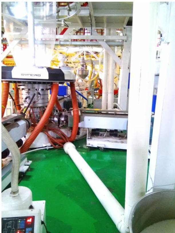
吹膜废气环形模具圆周抽排管道收集系统
