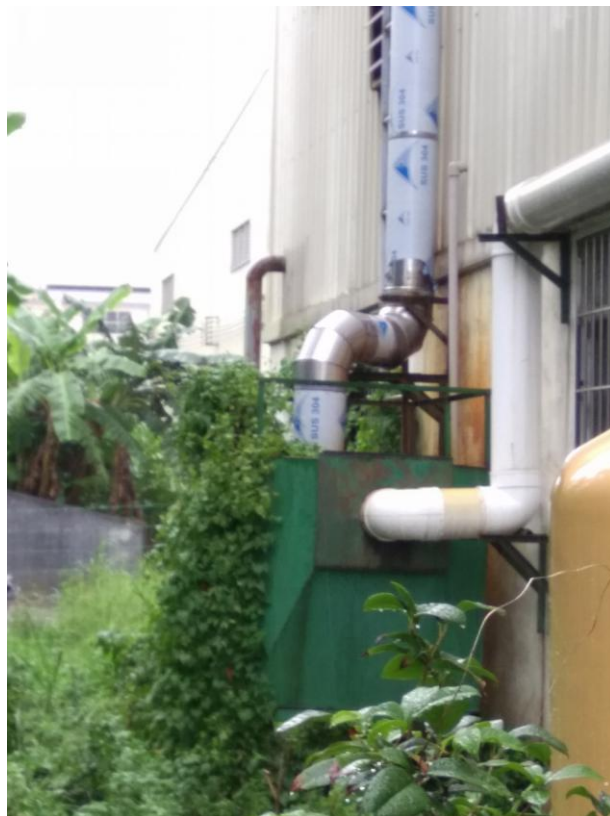
吹膜废气户外处理设施
