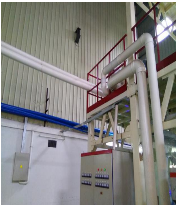
废气输送管道
