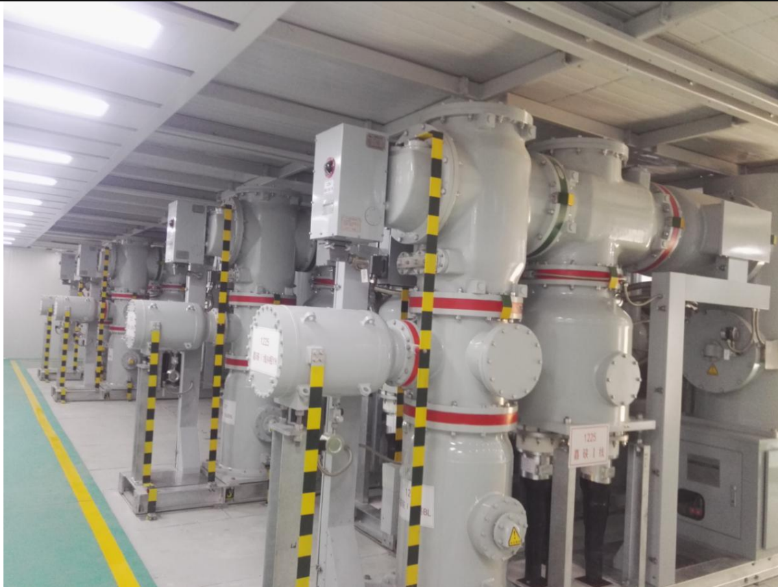
图 1.4-5 110kV GIS 预制舱模块（内）
