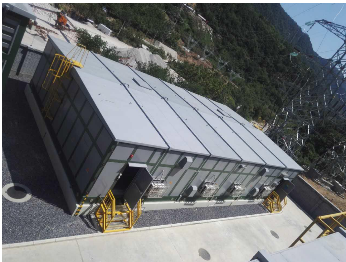
图 1.4-4 110kV GIS 预制舱模块（外）
