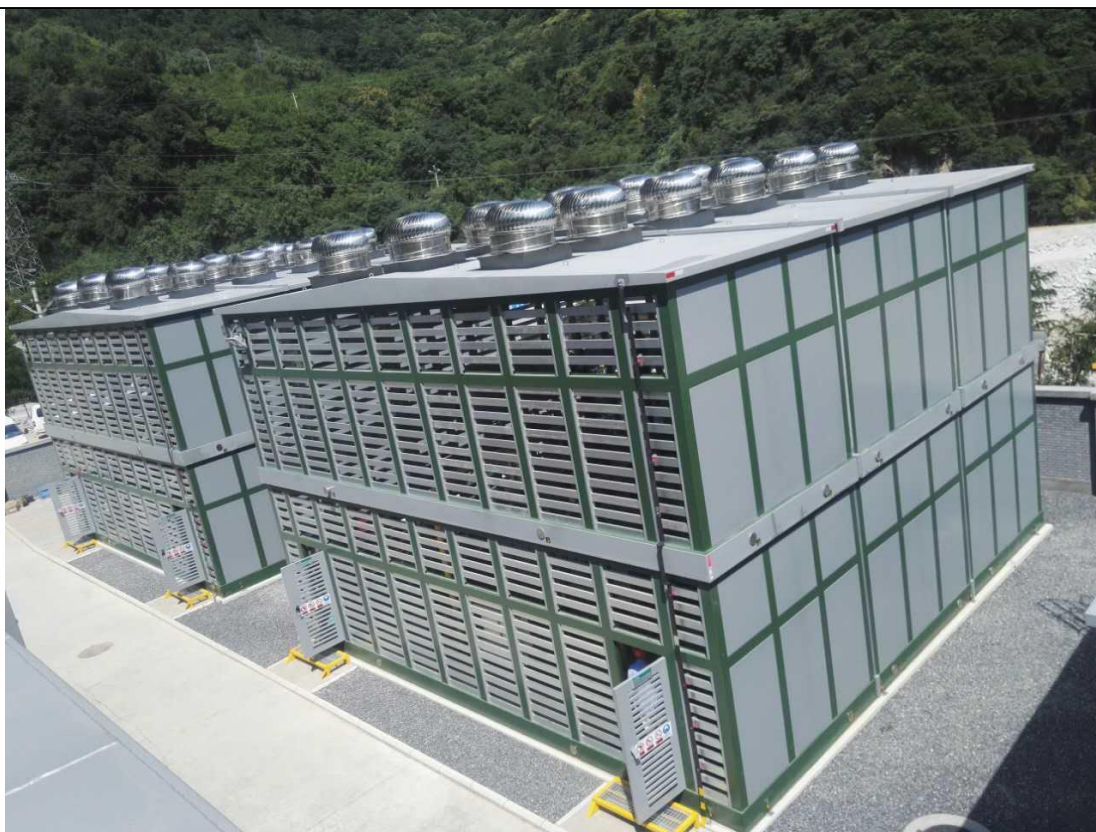
图 1.4-3 110kV 变压器预制舱模块
