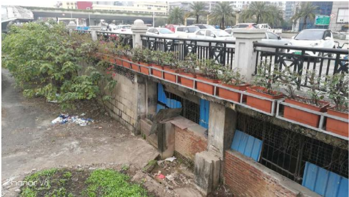
图2-1 现状废弃首层架空处
