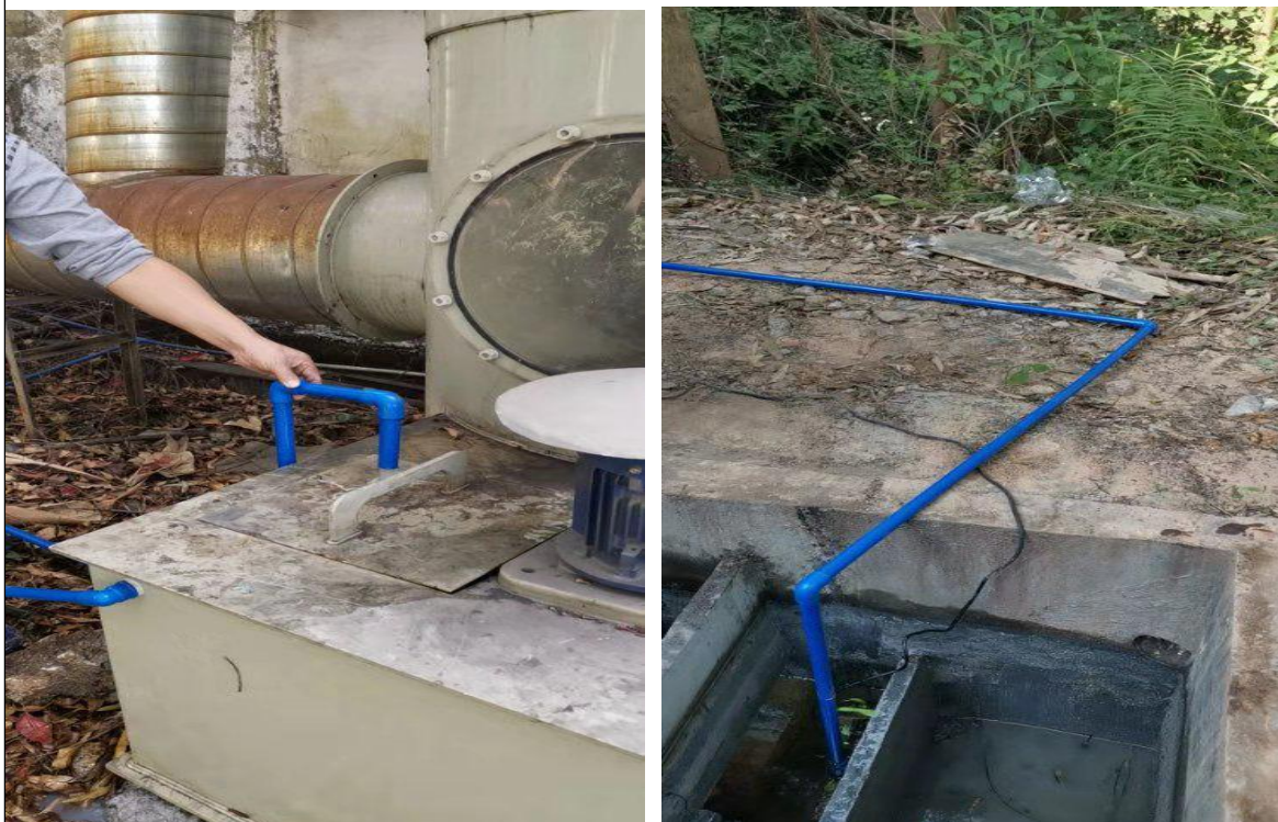
除油废水处理回用于喷淋塔
