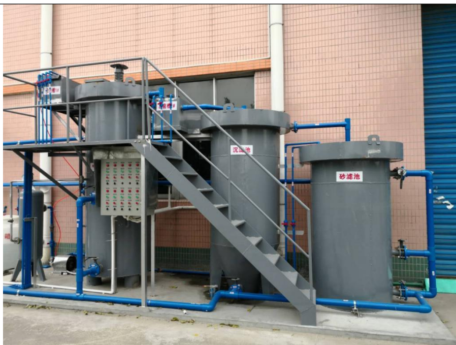
反应池+沉淀池+砂滤池
