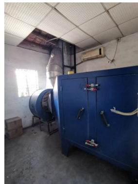
2号厂房活性炭吸附塔
