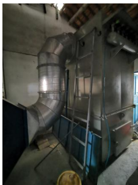
2号厂房布袋除尘器
