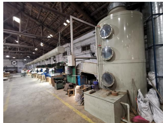
3号厂房水喷淋塔
