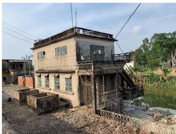
横江海口泵站
