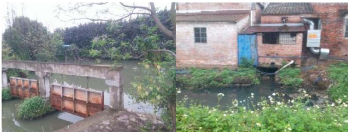
图 3.2-1 棠下镇中心区排水分布图及现状排水图片（整改前）
