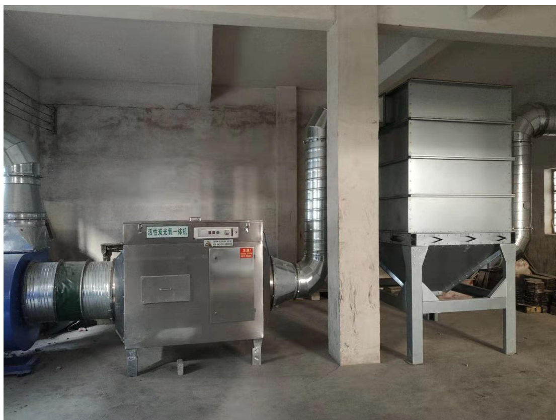
图7-3 废气治理设施现场图
