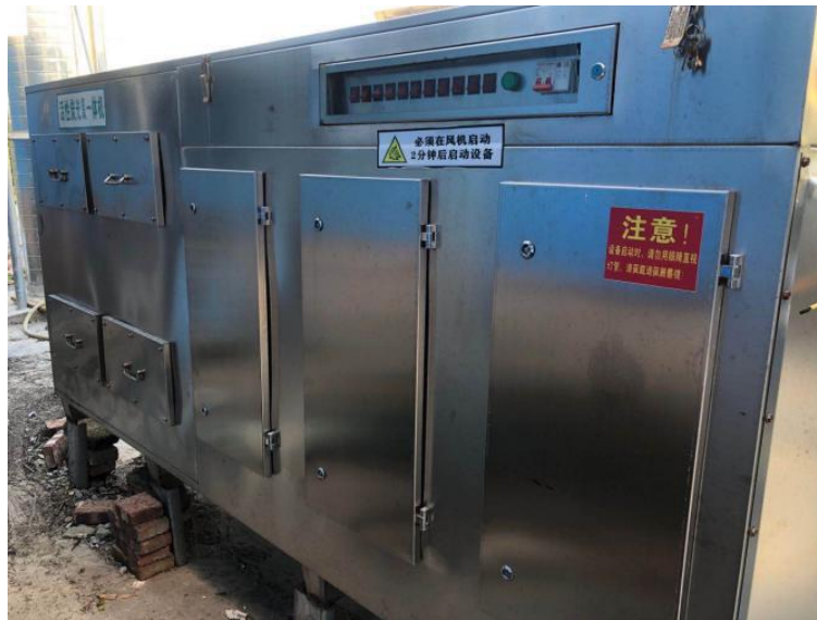
图7-5 废气治理设施现场图
