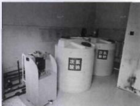
废水处理加药系统
