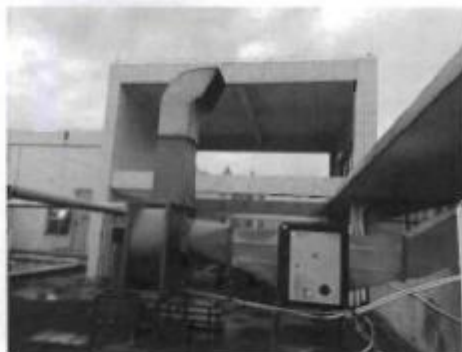
厨房废气配套处理设施排放口
