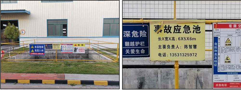
图 4-4 项目十二车间南侧道氏公司已建事故应急池
