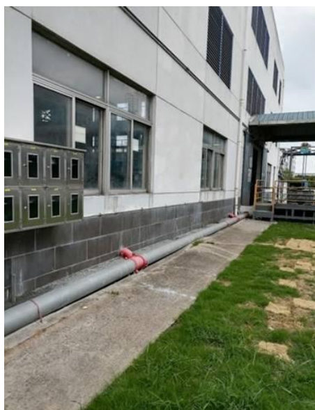
车间事故废水收集管
