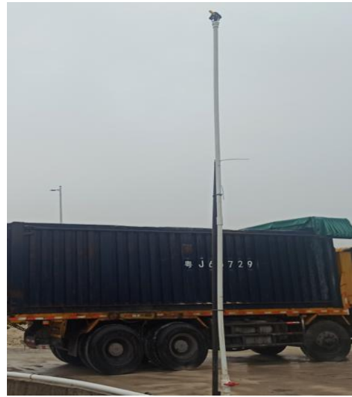
图3.3.2-2 砂石堆场水雾喷淋管（白色管）
