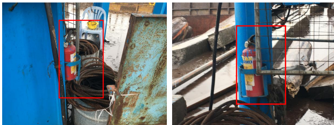
图 3.2.6-11 码头消防设施 2
