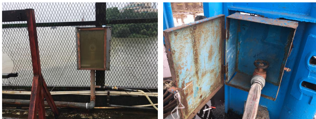
图 3.2.6-10 码头消防设施 1
