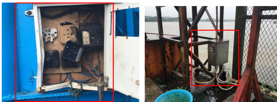
图 3.2.6-7 码头配电设施 2
