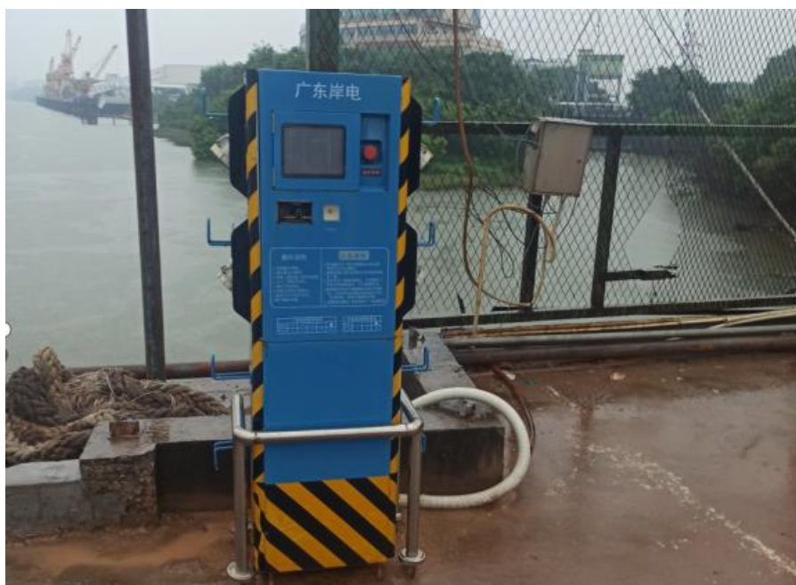
图 3.2.6-6 码头配电设施 1
