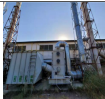
活性炭吸附+喷淋塔
