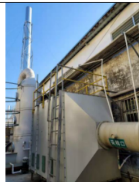
活性炭吸附+喷淋塔
