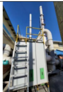
活性炭吸附+喷淋塔
