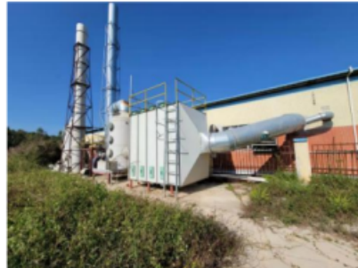
活性炭吸附+喷淋塔
