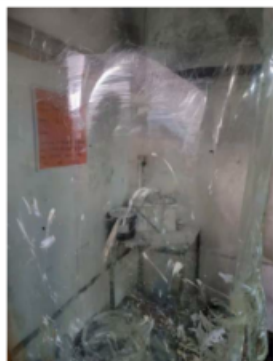
调油墨区域 集气罩（三面软帘）
