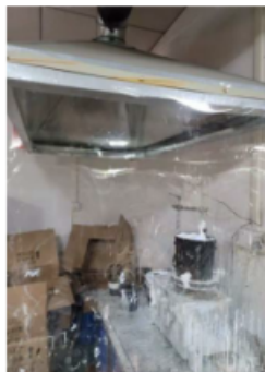
调油墨区域 集气罩（三面软帘）
