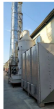
活性炭吸附+喷淋塔
