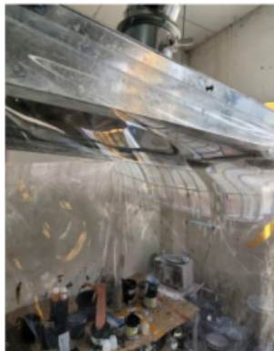
调油墨区域 集气罩（三面软帘）
