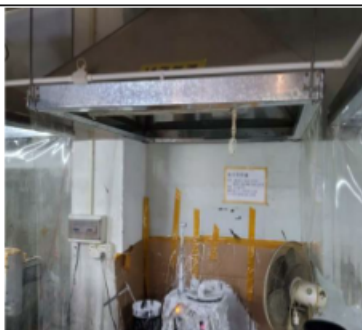
调油墨区域 集气罩（三面软帘）
