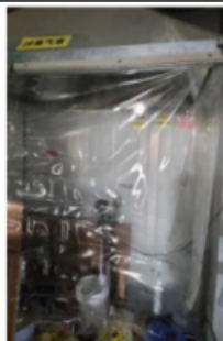
调油墨区域 集气罩（三面软帘）
