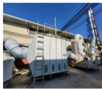
活性炭吸附+喷淋塔
