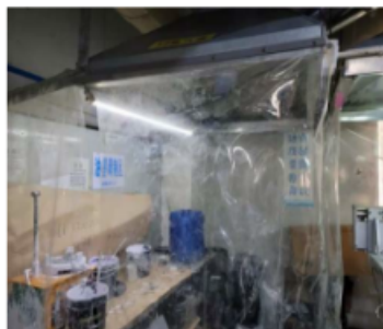
调油墨区域 集气罩（三面软帘）
