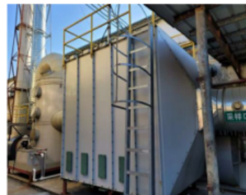
活性炭吸附+喷淋塔
