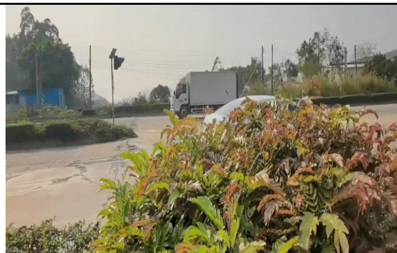
跨河桥路面典型病害情况
