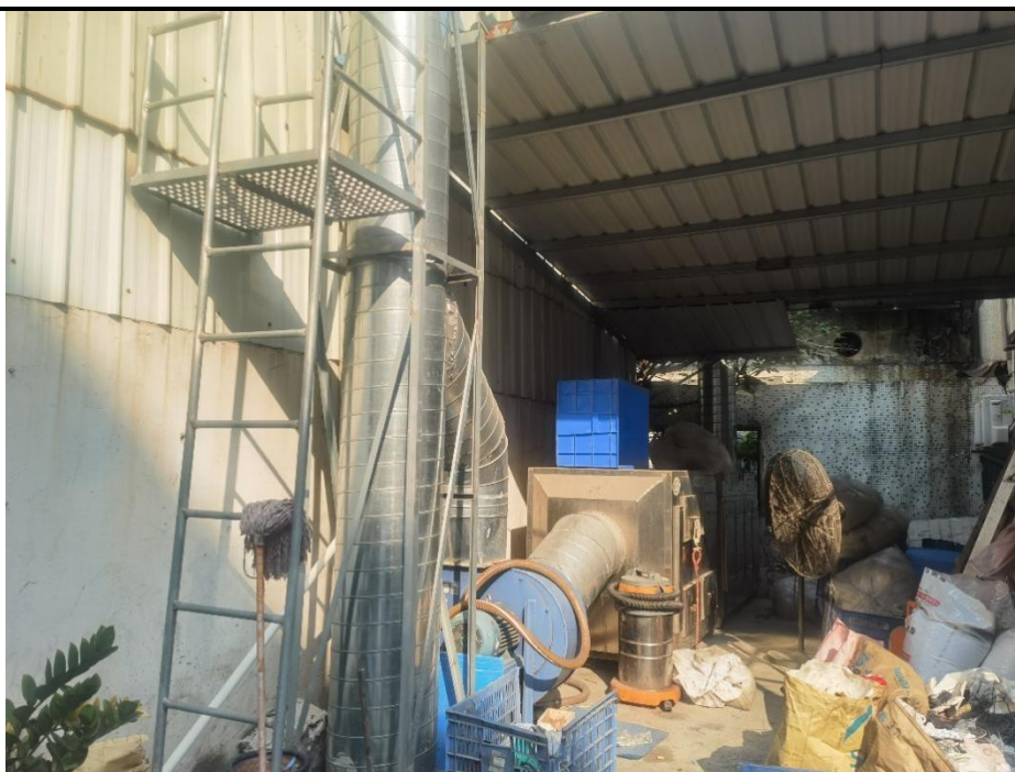
二级活性炭箱、排气筒、采样口照片
