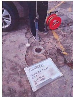
7: W1 地下水采样口
