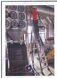
3#厂房投料、密炼、开 炼废气 DA006 处理前
