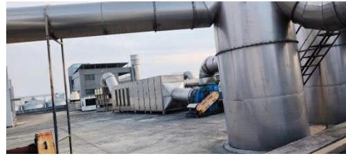
废气处理设施
