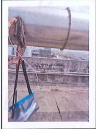
1#厂房硫化成型、脱模 废气 3#DA001处理前
