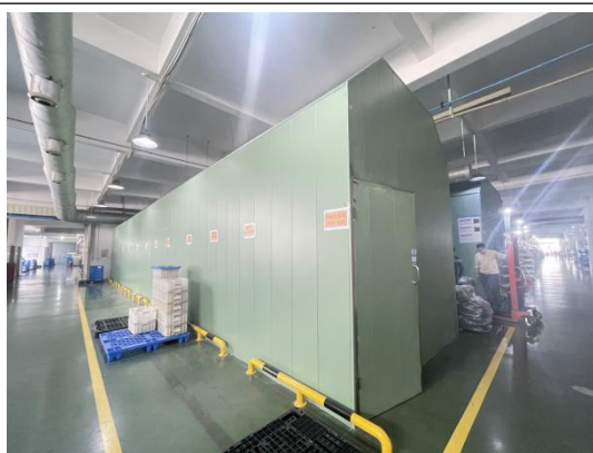
硫化作业区（半密闭车间收集）
