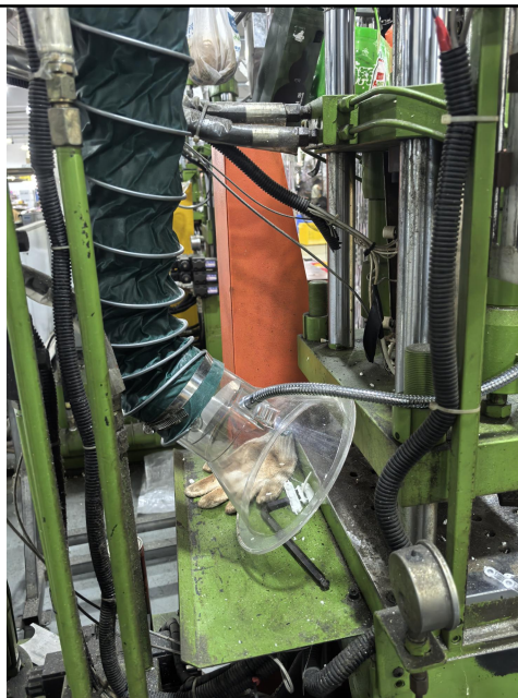
注塑废气收集方式照片
