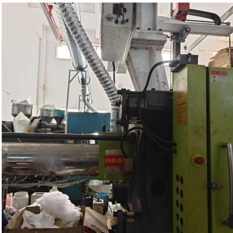
图 4-1 废气集气罩照片
