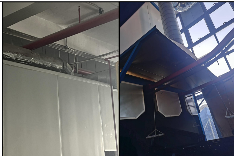
图4-2 固化废气（左：直连抽气管道；右：进出口集气罩）收集示例图
