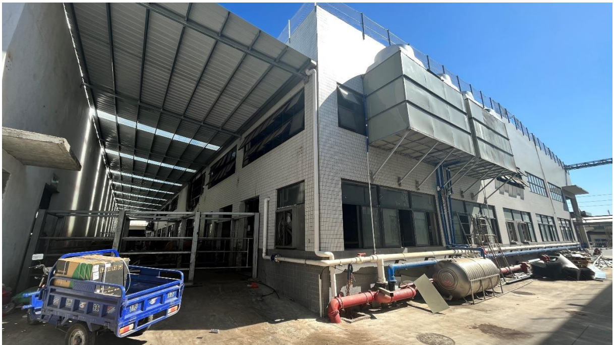
屠宰车间废气治理设施（喷淋除臭）
