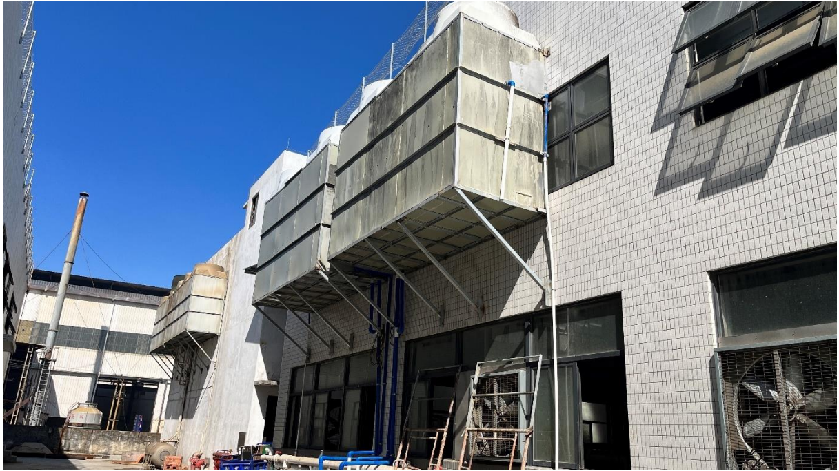
待宰车间废气治理设施（喷淋除臭）
