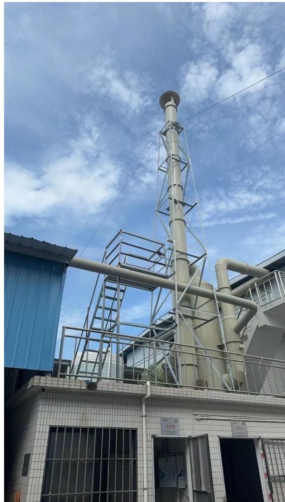
污水站臭气治理设施及排气筒
