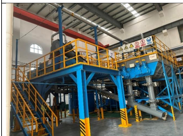
污泥干化车间内部
