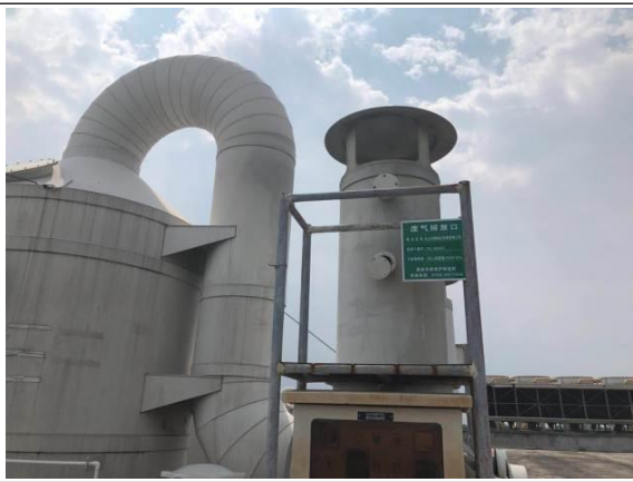
碱液喷淋塔及排气筒
