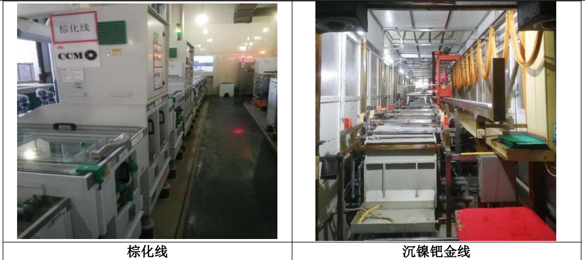
图 2-24 现有工程生产线照片
