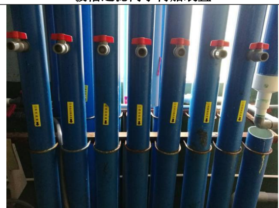
车间废水分类收集管道
