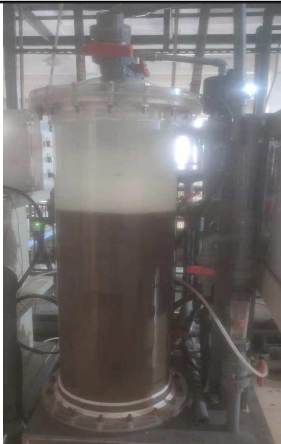
镀槽过滤离子树脂装置
