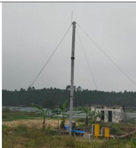
沼气燃烧排气筒
