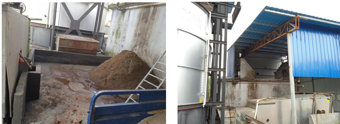
图 3.3-4 固液分离机出粪区一干粪暂存区
