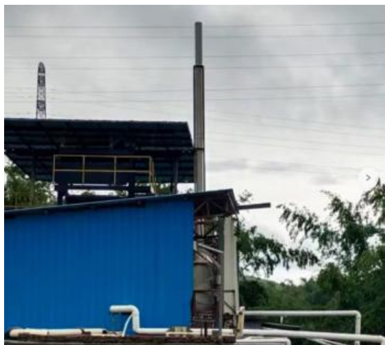
粪污发酵排气筒
