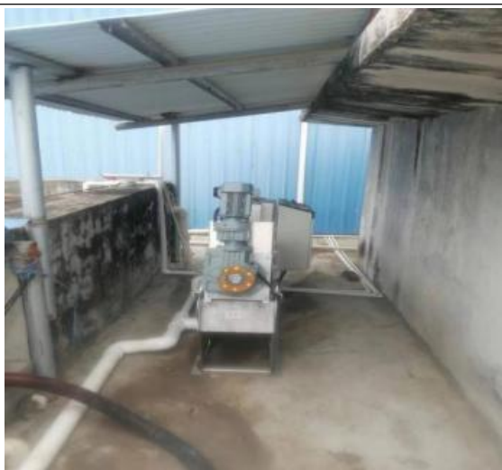
污泥压滤机防雨棚
