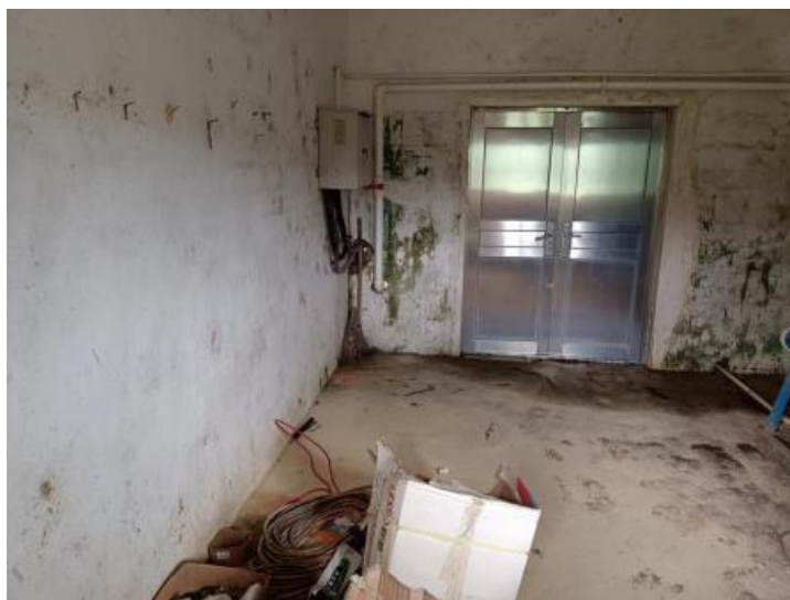
图 2.7-1 现有项目危废暂存间照片
