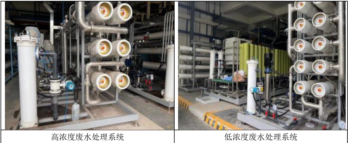
图3.4-2 现有项目废水处理措施照片
