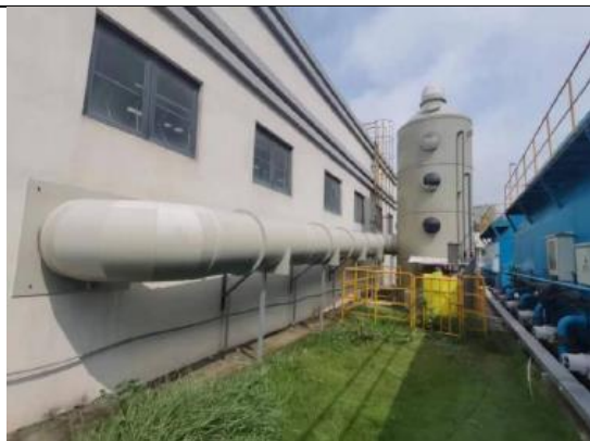
水喷淋除氨设备（飞灰固化物养护车间）
