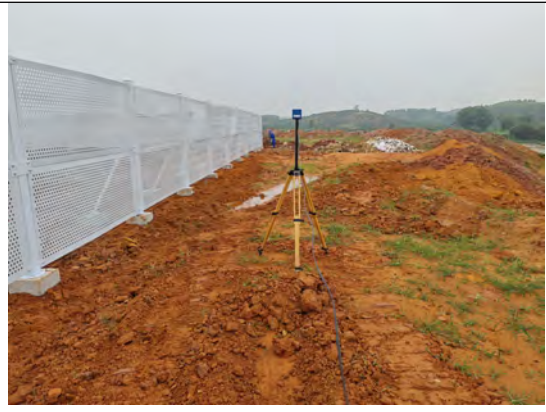
110kV 鹤南站间隔扩建侧
