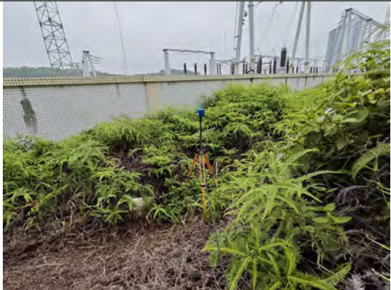
110kV 月山站间隔扩建侧厂界
