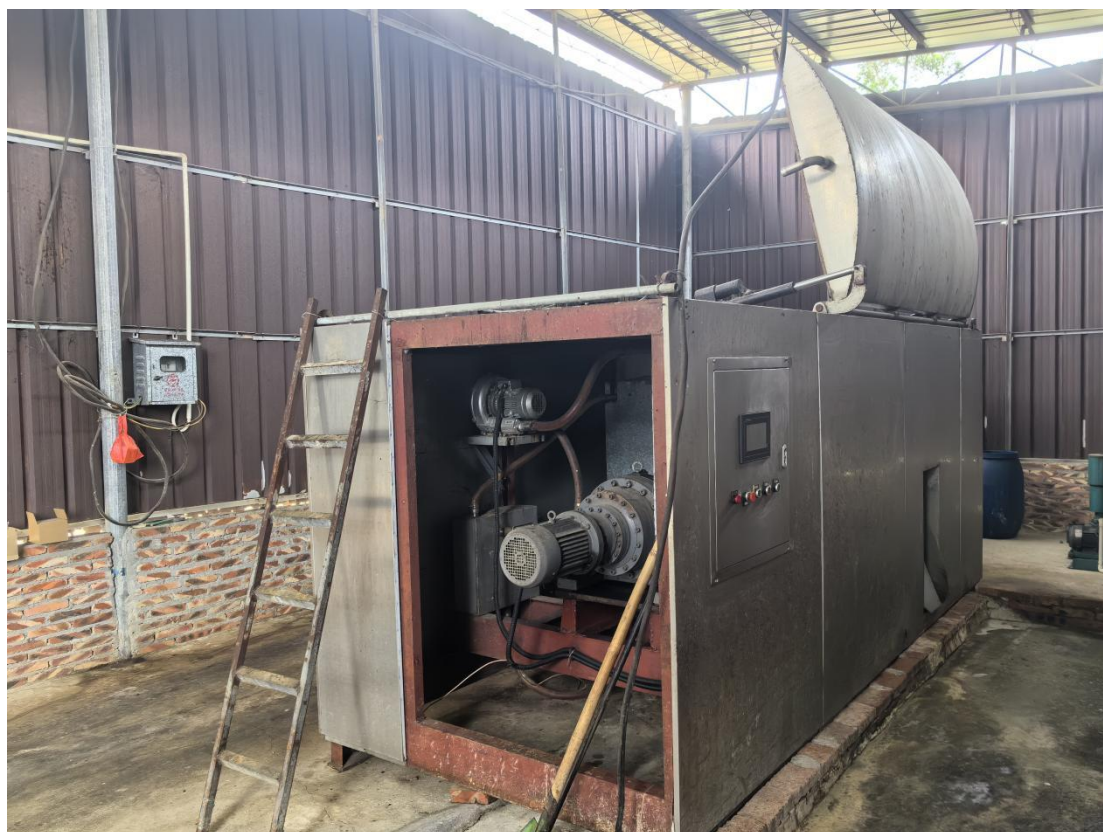
图 3.2-7 无害化处理设备
