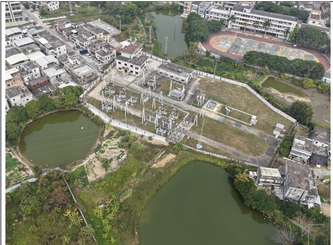
110kV 金鸡变电站站区航拍图
