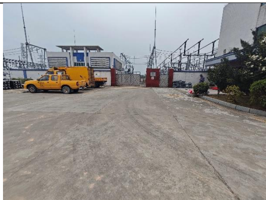
220kV 百合站厂界北侧
