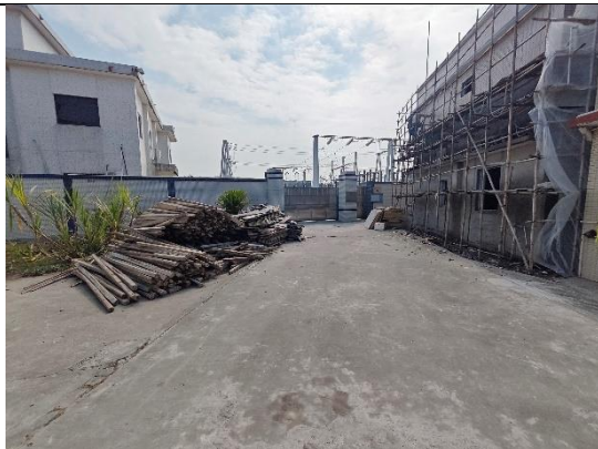
110kV 金鸡变电站厂界西北侧
