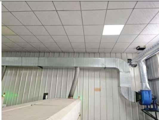
回流焊炉废气排口直连
