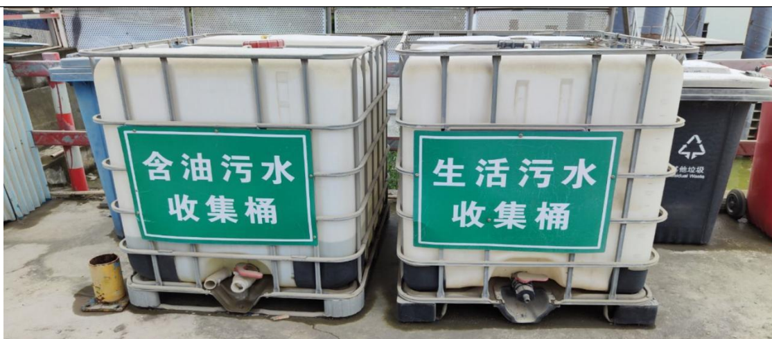
图 4.2.5.5-7 码头油污收集设施现状
