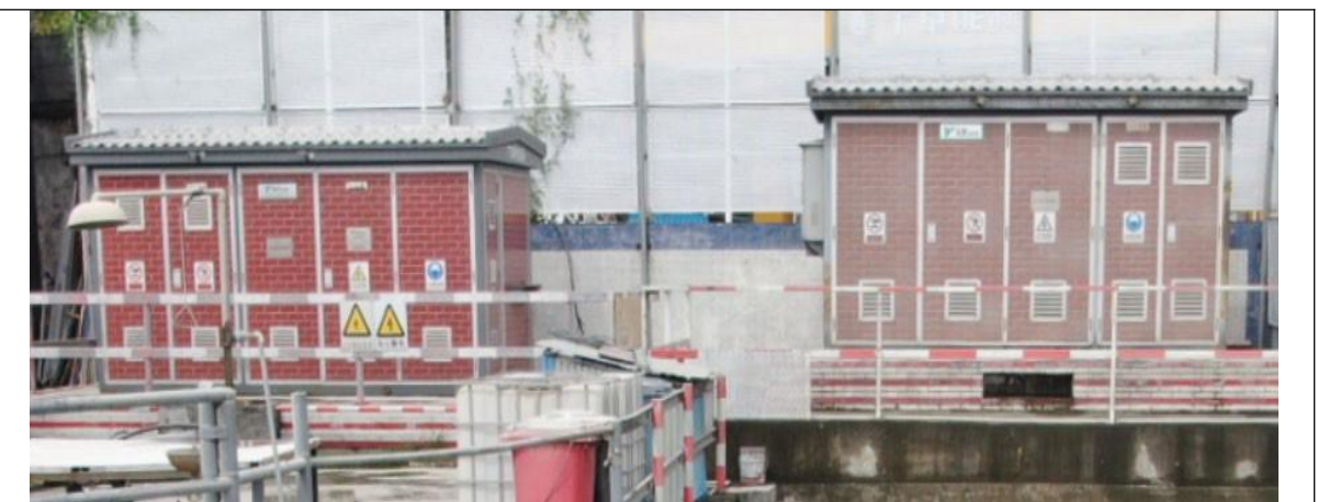
图 4.2.5.5-5 码头岸电设施现状照
