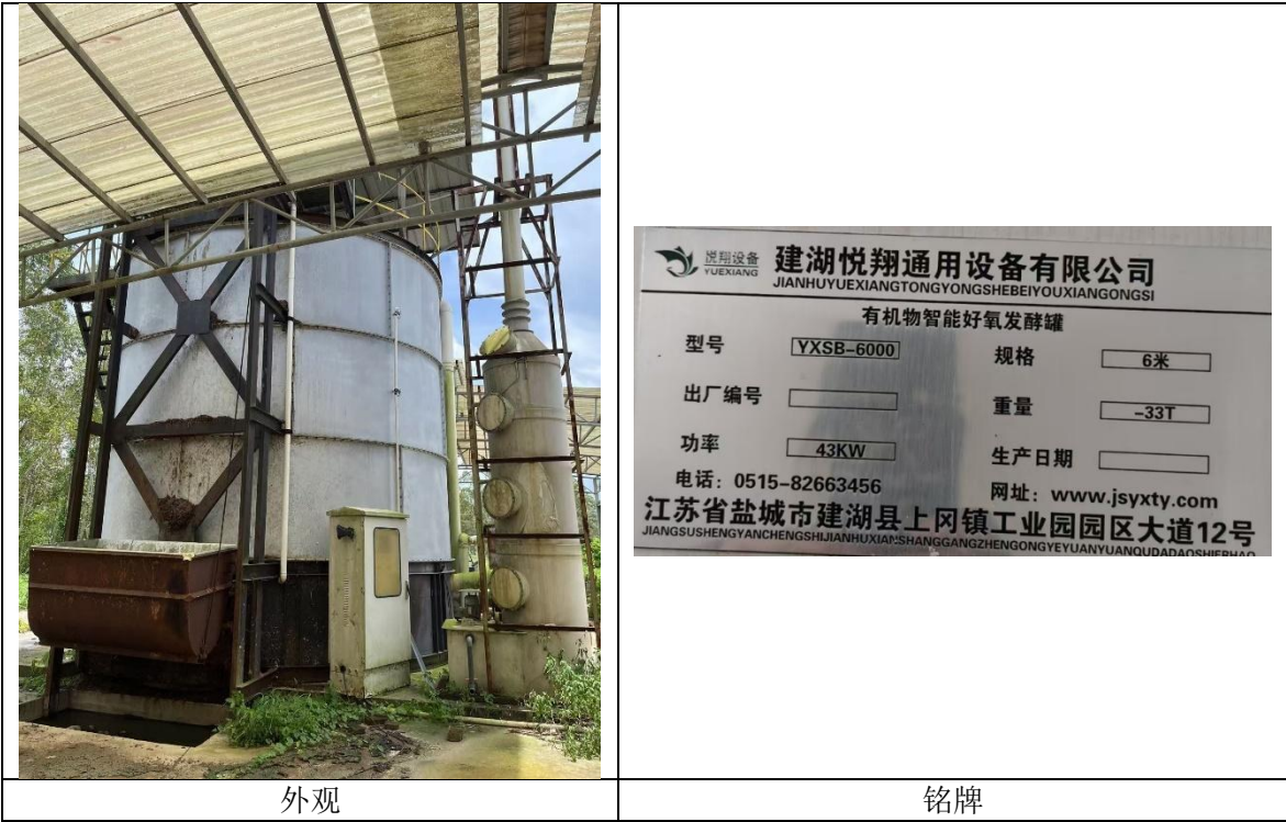
图 4.2-3 项目发酵罐照片
