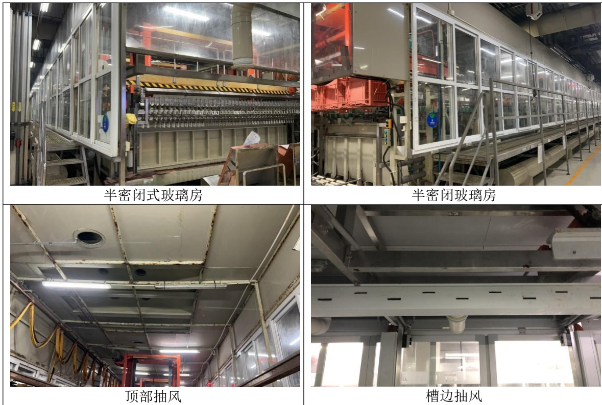
图 1.2.7-1 (a) 垂直电镀线废气收集措施实拍图
