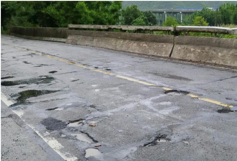
桥梁铺装破损
