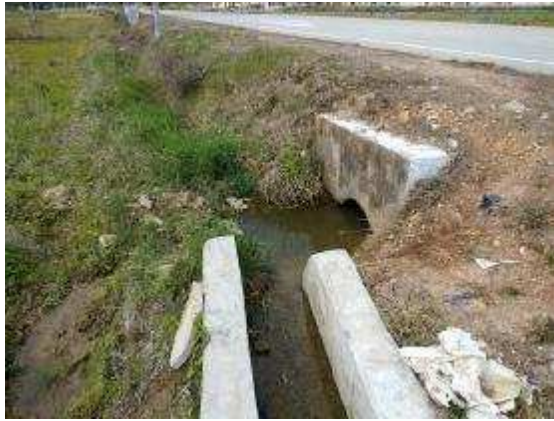
道路沿线农灌渠（涵洞）
