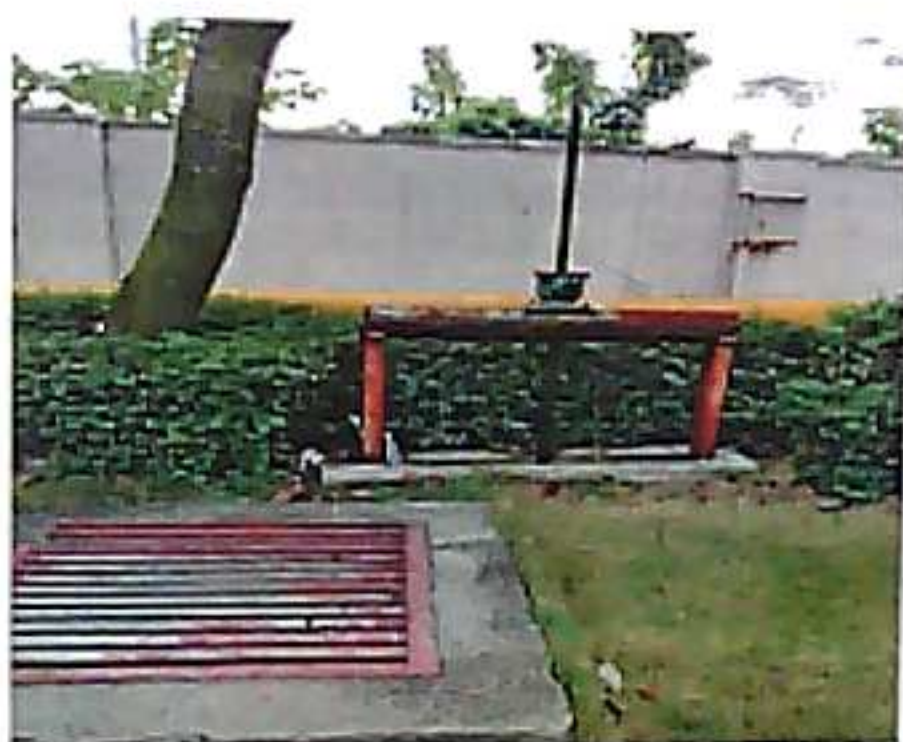
总排口和雨水闸门
